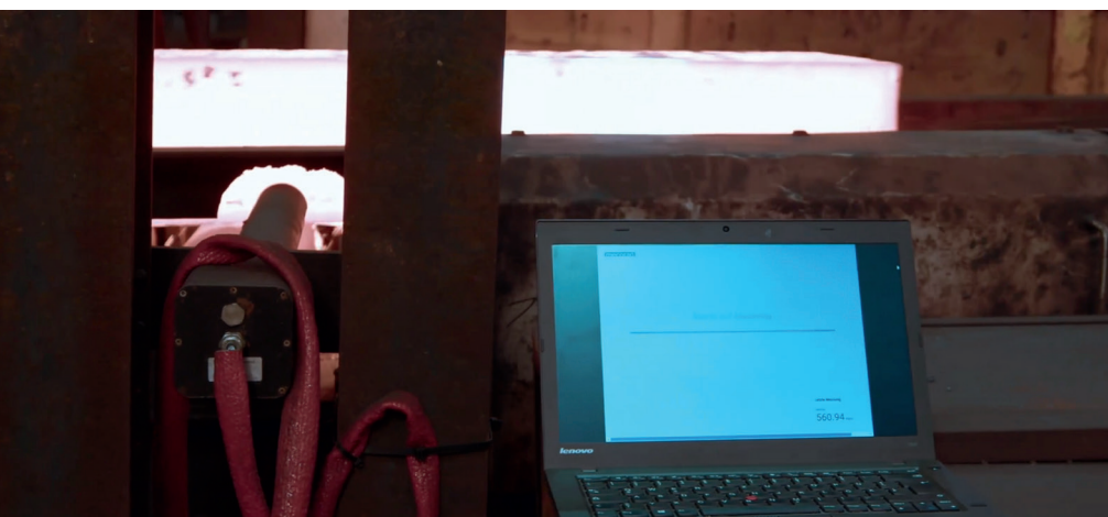
Inbetriebnahme einer radarbasierten wtl series Breitenlösung an einer Warmwalzlinie (Foto: mecorad GmbH)
